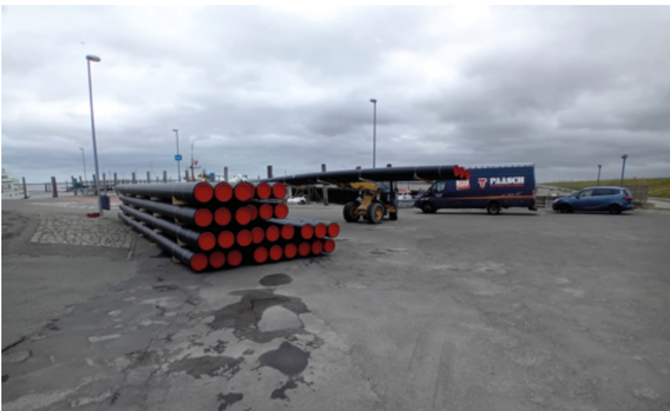
Für die beiden Anlandungsbereiche auf der Hamburger Hallig und auf der Insel Pellworm kamen Horizontalspülbohrungen (HDD) mit Schutzrohrinstallationen zum Einsatz.
