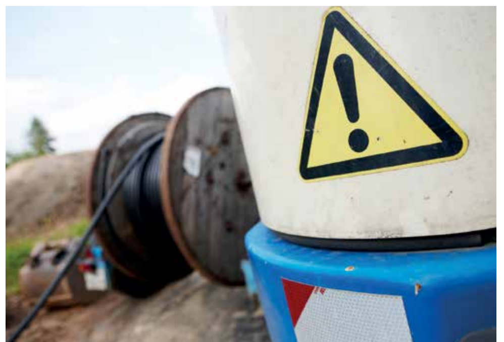
Das Erdkabel als neuer Standard – dahinter stehen noch einige Fragezeichen. (Foto: © fotolia | Christian Schwier)
