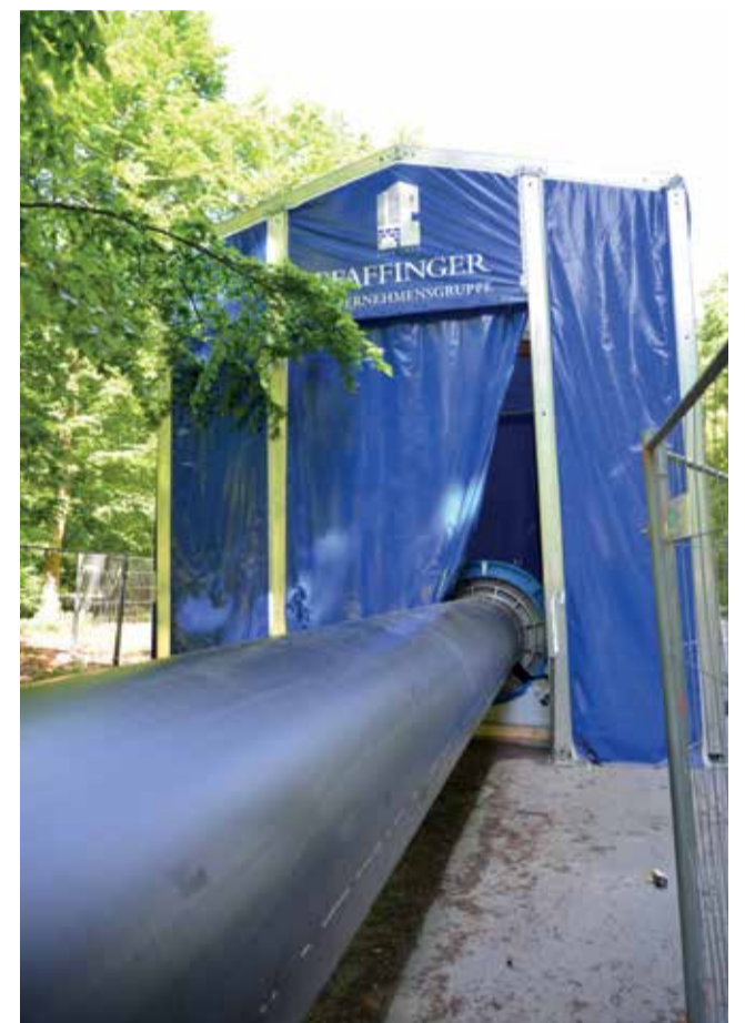
Sämtliche Schweißarbeiten wurden witterungsunabhängig in einem im Englischen Garten errichteten Zelt vorgenommen.
