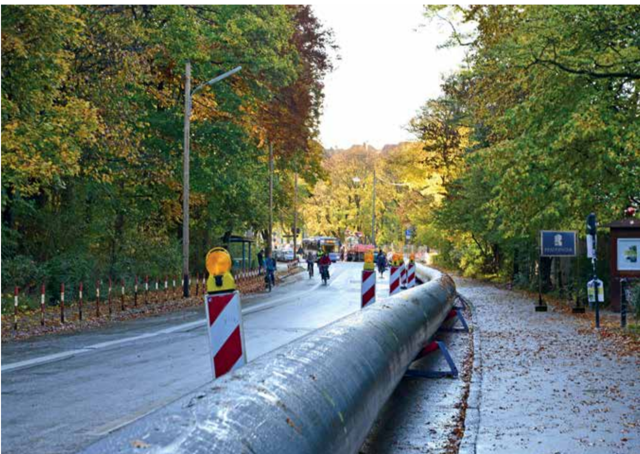
Bis zum Einzug wurden die bis zu 300 m langen Rohrstränge auf Rollenböcken gelagert.
