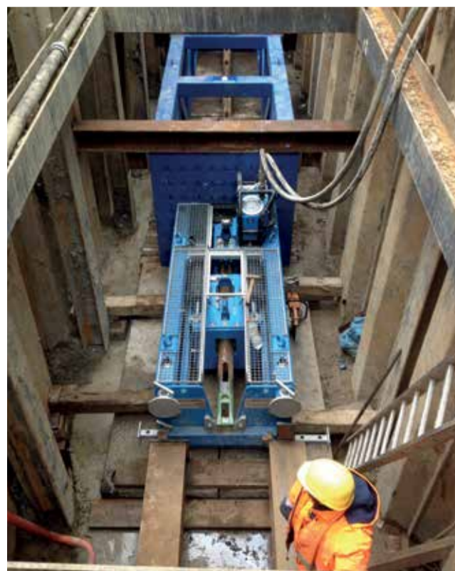
Auf geraden Leitungsabschnitten erfolgte der Einzug des PE-Rohrstrangs mithilfe einer in der Maschinengrube eingesetzten Gestängeanlage.
